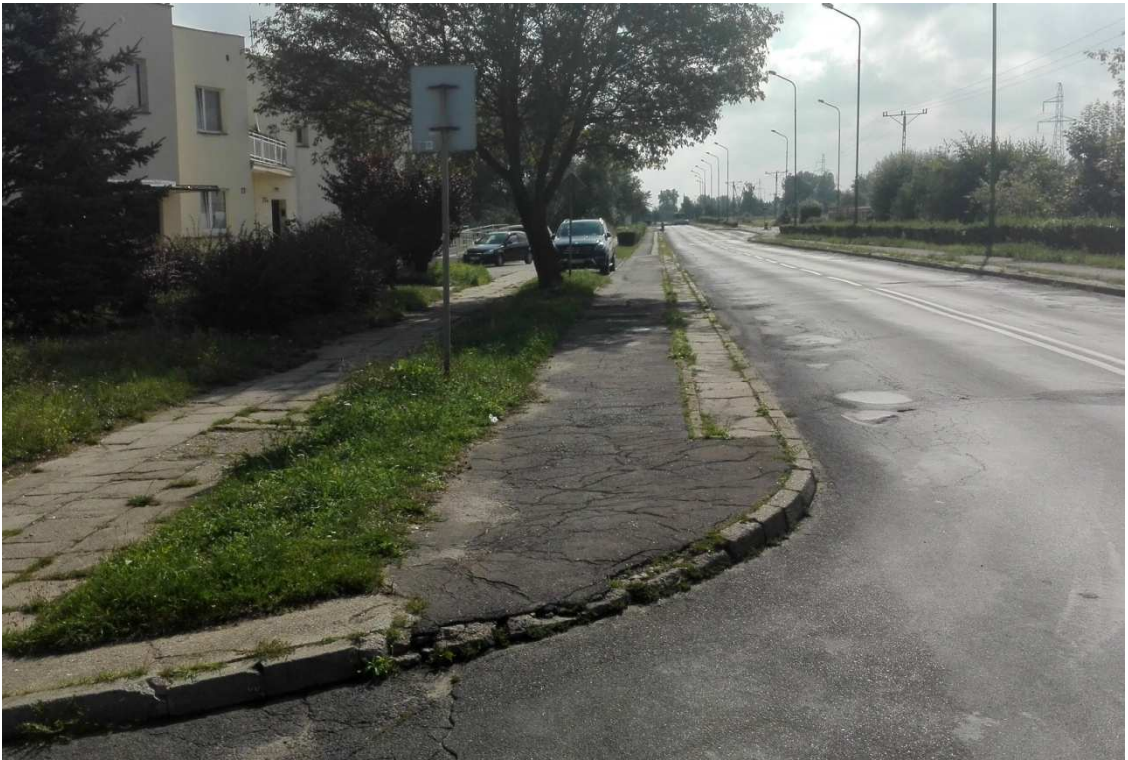
Fotografia 2 Zniszczona nawierzchnia starej drogi dla rowerów – ul. Sudecka
