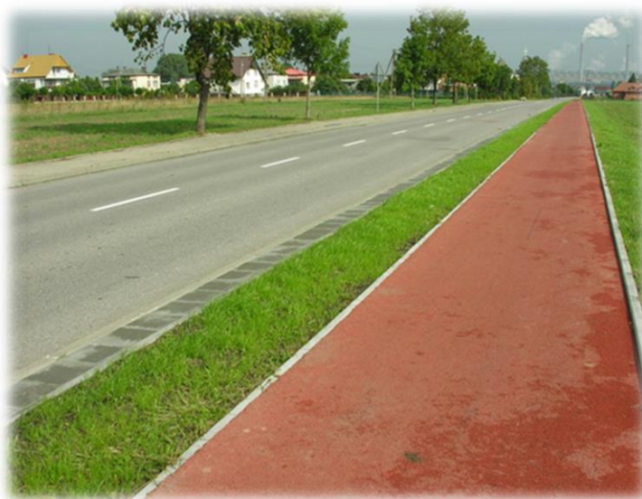
Ryc.91. Foto.64. Przykład ścieżki rowerowej dwukierunkowej wykonanej z masy asfaltowej w kolorze czerwonym, nawierzchnia asfaltowa w terenie niebudowanym. Źródło: archiwum M&G .
