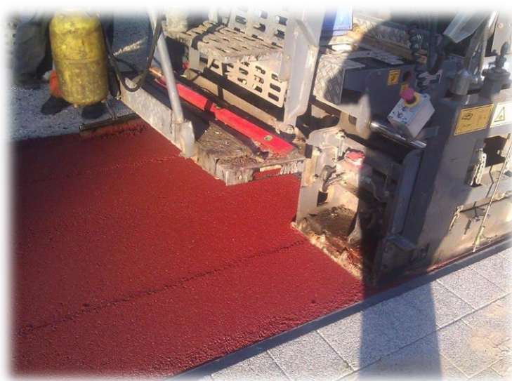
Ryc.68. Foto.25. Przykład technologii wykonania dwukierunkowej drogi dla rowerów w terenie zabudowanym z nawierzchni asfaltowej kolorowej (czerwonej – bezpiecznej i widocznej)).
