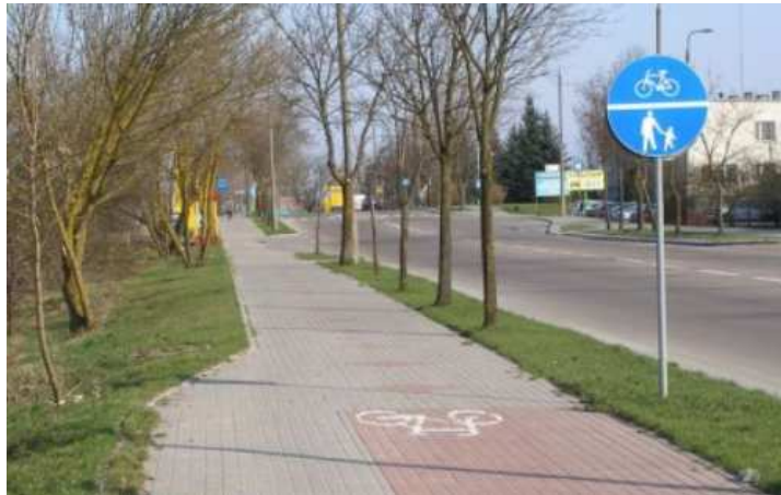
Rys. 3.21 Przykładowa lokalizacja istniejącego ciągu pieszo-rowerowego z błędnym oznakowaniem [22]
