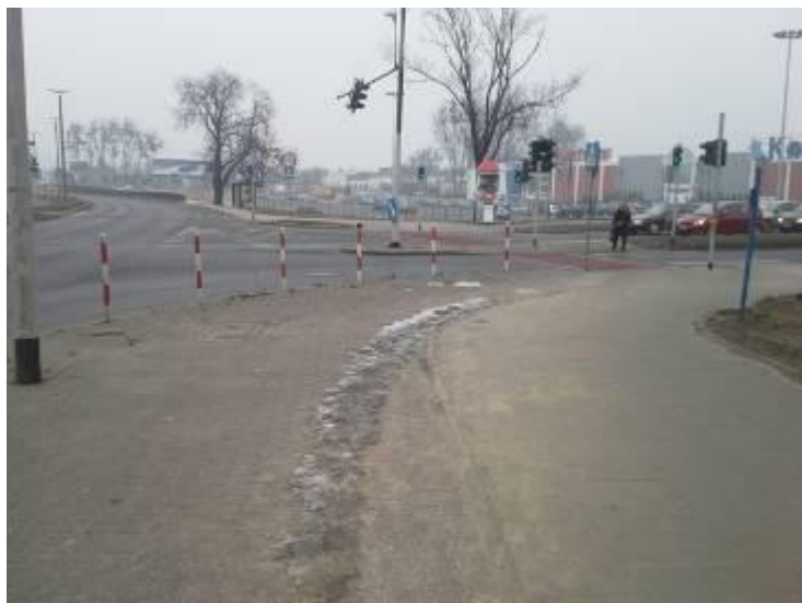
Ryc. 58. Przykład niewłaściwego utrzymania infrastruktury rowerowej
