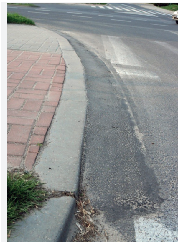
ZDJĘCIE 75. Wylewka z masy bitumicznej ułatwiający podjazd na krawężnik - rozwiązanie tymczasowe.
